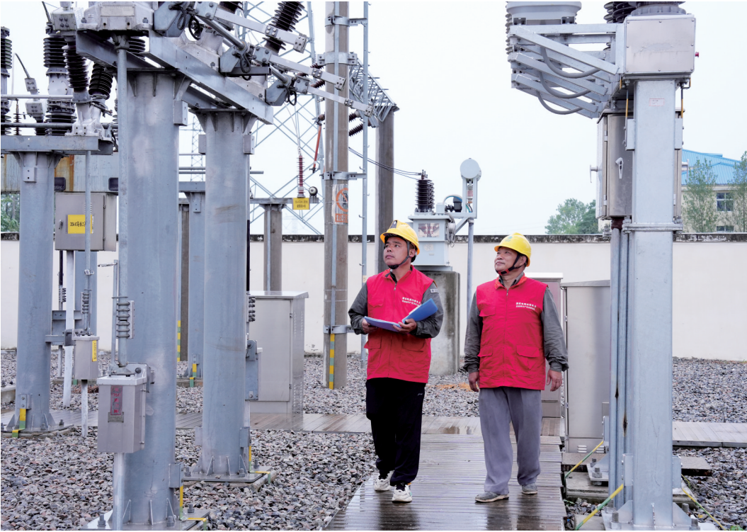
8月17日，息县供电公司组织工作人员对35千伏夏庄变电站进行巡视，及时排查和消除设备隐患，确保电网安全稳定运行。 项巍 摄
