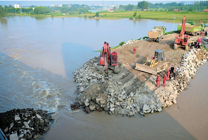
这是 8 月 15 日拍摄的河南周口贾鲁河堤坝溃口作业现场。 新华社记者 郝源 摄
