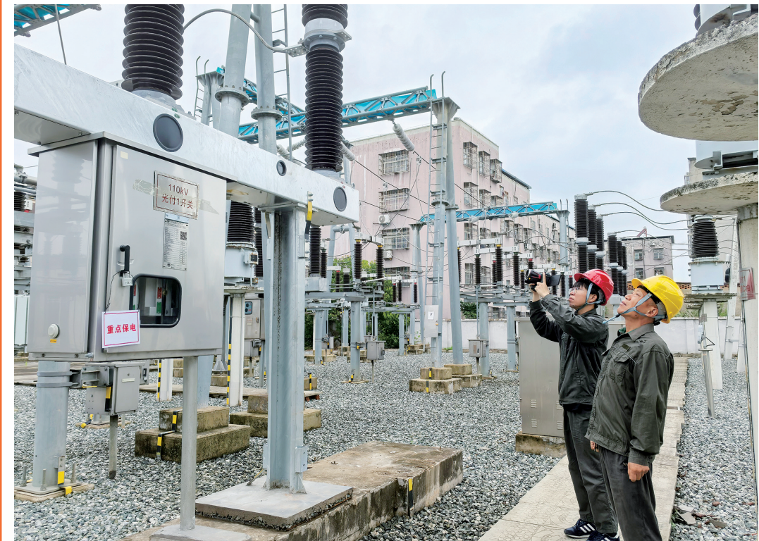
近日，光山县供电公司运维人员深入 110 千伏紫光变电站，开展高温专项特巡，重点对主变压器、GIS 等核心设备进行巡视检测，排查设备安全隐患，确保电网安全稳定运行和电力可靠供应。 张磊 摄
