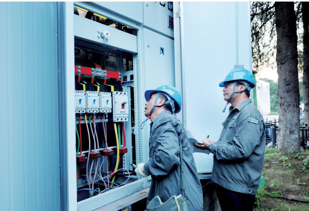
近日，在光山县第四届乡村儿童艺术嘉年华活动现场，光山供电公司工作人员仔细检查供电线路、测量设备温度，紧盯用电关键点位，保障活动全程安全可靠供电。
