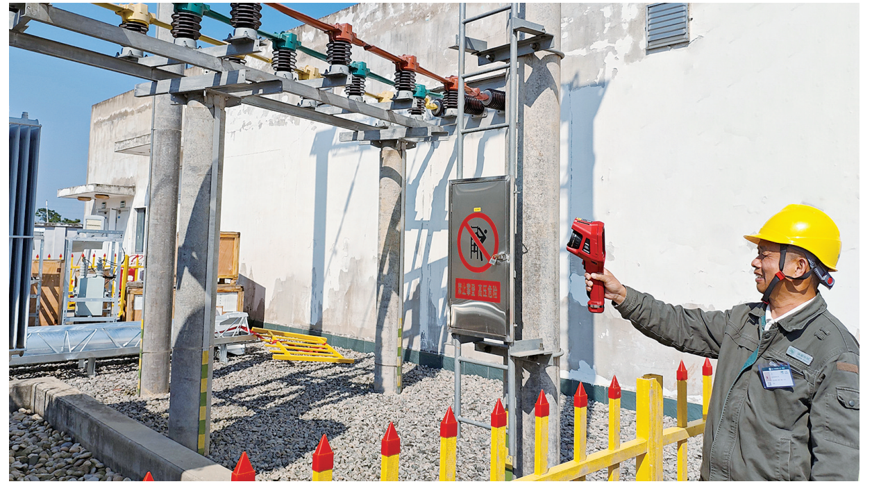
5月以来,县供电公司密切关注天气变化,精准开展负荷预测,科学优化电网运行方式,实时响应客户需求,持续提升供电服务质效。图为该公司组织变电运维人员对辖区内35千伏变电站设备开展专项巡视、测温及隐患排查工作,全力保障电网安全稳定运行和电力可靠供应。张棋清 摄
