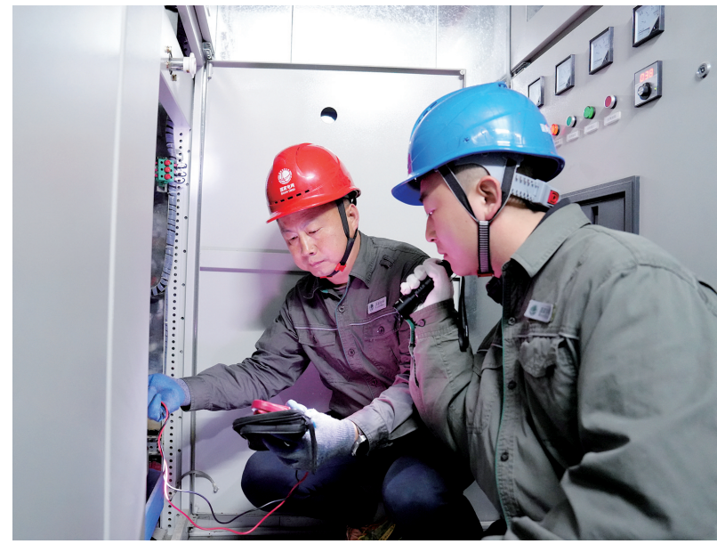
4月27日,新县供电公司新集供电所党支部组织党员在夜间用电高峰时段,对供电辖区内部分台区及电缆线路进行测温,并开展降线损专项行动,着力保障“五一”期间电力可靠供应。 鲁晶晶 摄
