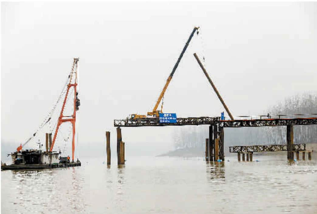
临近年终,各大重点项目都在紧锣密鼓地加紧建设。图为12月14日,工人正在为G328线淮滨段淮河公路特大桥的施工便桥下钢管桩基。G328线淮滨段淮河公路特大桥是2016年市重点项目——新增国道G328淮国交界至淮滨县城段改建工程地一部分,桥全长2978.56米,总投资1.83亿元,预计2018年5月份建成通车。李鹏 夏训巍 摄
