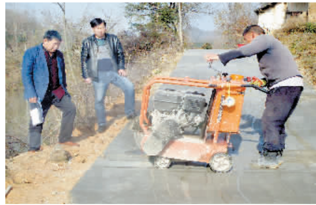
12月7日,漯河区谭家河乡凌岗村的驻村第一书记程军明(左二)正在查看工人切割新修的水泥路伸缩缝。据悉,凌岗岗村后,程军明针对当地交通落后、信息闭塞等情况,多方筹措资金,硬化了4条村组道路,方便了群众的生产生活。彭延斌 摄
