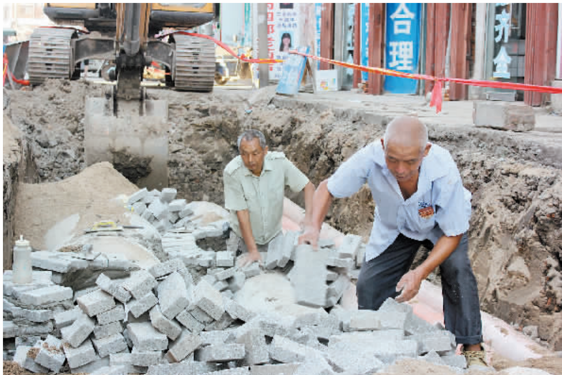
明港镇自2015年7月被确定为国家级建制镇示范试点以来，扎实推进民生工程，积极实施旧镇区改造、启动棚户区改造，城镇居民居住环境得到明显改善。图为昨日施工人员在明港镇中山街对老旧道路重建并铺设雨污分流管道时的场景。
