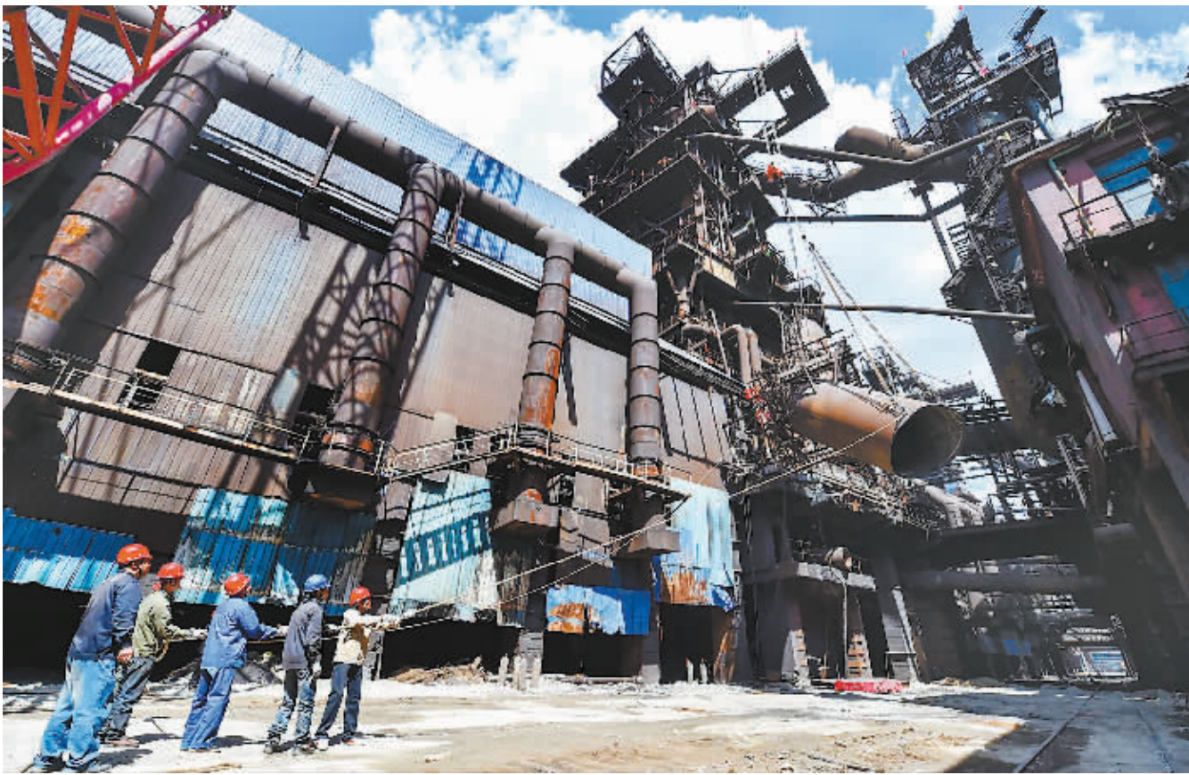
8月31日，施工人员在牵引被拆除的2号高炉下降。当日上午，包头钢铁集团炼铁厂2号高炉拆除工作正式启动，这是全国钢铁行业推进去产能以来拆除的最大一座高炉，可压缩炼铁产能133万吨。新华社记者 连振 摄
