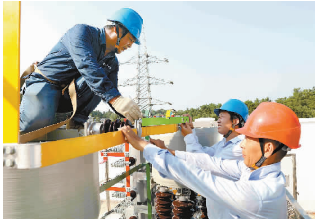
7月27日,信阳110千伏绿水变电站外电设备设备安装完成90%。信阳供电公司工作人员正冒着37℃的高温抢建电网,确保电网如期运行。 杨帆 刘威 摄
