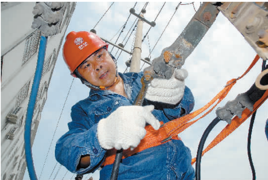
在夏季高温用电大负荷来临之前,为排除安全隐患,6月14日,罗山县供电公司组织人员分组对全县公用台区配变设备进行全面检修,为迎峰度夏期间设备稳定运行打好基础。图为该公司员工正在检修变压器。
