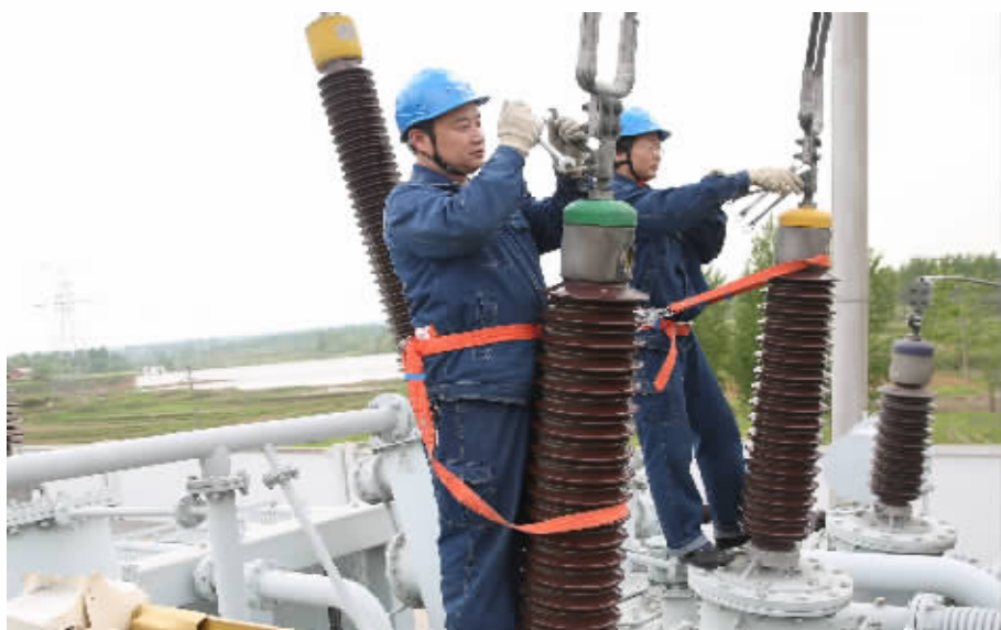
4月19日,信阳供电公司检修分公司变电检修室集中兵力,对220千伏曹湾变电站开展春检。春检现场,该公司一次、二次及高压试验各专业协同配合,整个工作现场严谨、高效、有序。 杨帆 刘威 摄
