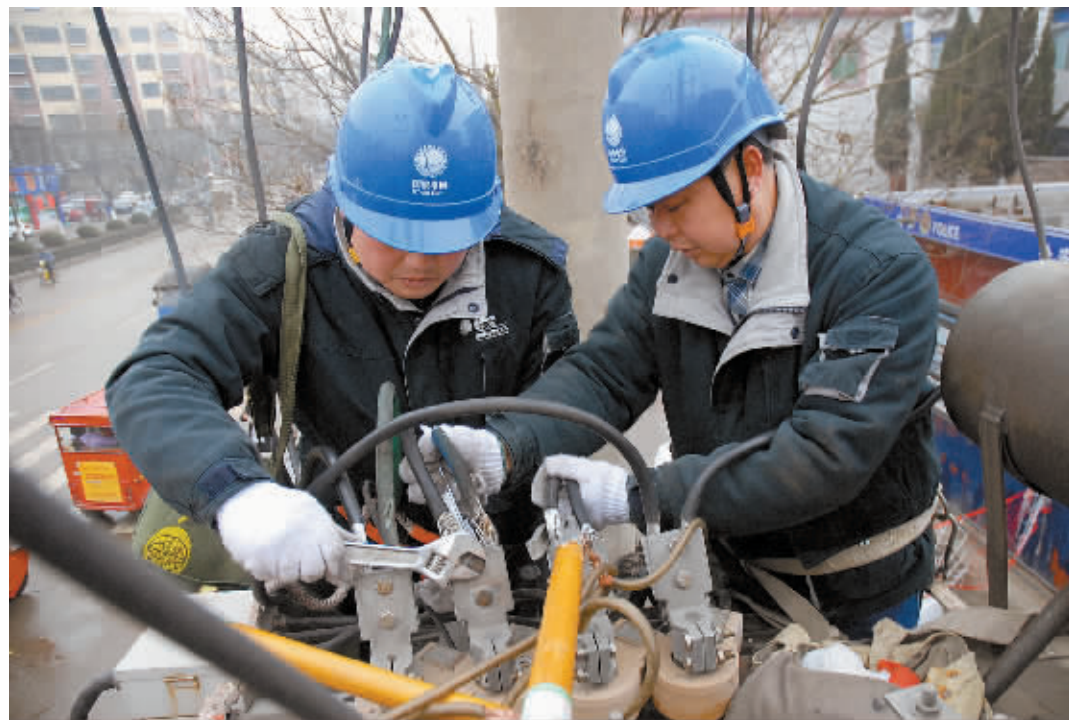
昨日,罗山县供电公司开展城区低压配变检修消缺工作,集中排查城关区域所有公用低压配变,消除安全隐患和缺陷,保障设备在度冬及“双节”期间健康稳定运行。图为该公司职工正在对变压器进行检修时的场景。 魏思平 摄
