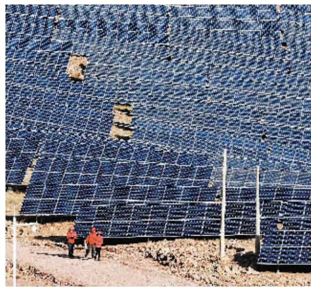
1月18日，工作人员在汝阳县蔡店乡山上村驼峰山光伏发电站巡查。
