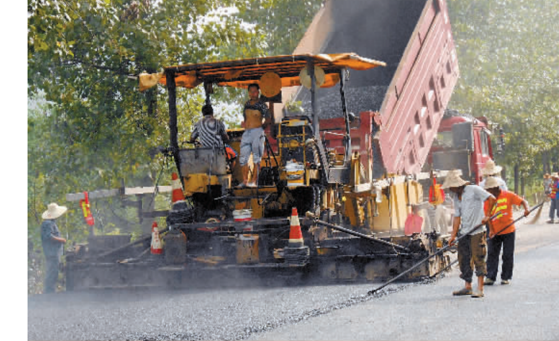
S224信应路是豫南通往湖北的“最后一公里”,由于车辆超载,致使路面破损严重,严重影响了交通安全。通过积极跑项争资,浉河区从今年5月份开始,对该路段路面进行修复,目前已进入最后的铺柏油工序,预计8月中旬可全面竣工。 彭延斌 摄
