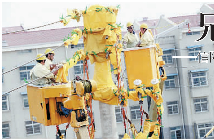
图为6月9日中午,信阳供电公司员工与平顶山供电公司员工联手进行线路迁改不停电作业时的场景。 甘仁伟 摄
