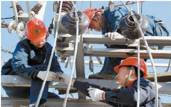
12月4日清晨,光山县电业局变电部员工正在35千伏白雀变电站内紧张施工。为提高迎峰度冬期间光山35千伏电网供电可靠性,结合各35千伏变电站主变容量、负荷预测情况,光山电业局多措并举,按照阶梯调整原则,对主变容量进行优化配置,为“双节”度冬保电再添新保障。
