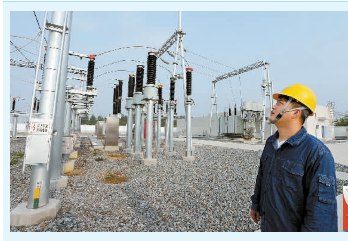
位于潢川县产业集聚区内的潢川县首座110千伏智能化变电站今年3月投入运行以来,线路设备运行正常。该智能变电站能自动完成信息采集、测量、控制、保护、计量和检测等基本功能,无需人员手动操作。同时,该变电站还具备支持电网实时自动控制、智能调节等功能。图为8月25日,值班人员巡查设备时的情景。本报记者 秦旭 摄
