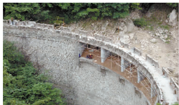
截至上周，淮河区谭家河乡已完成5座病险水库的除险加固，目前正在“扫尾”天平山和白鹤湾2座“病险”水库。图为天平山水库除险加固现场。
