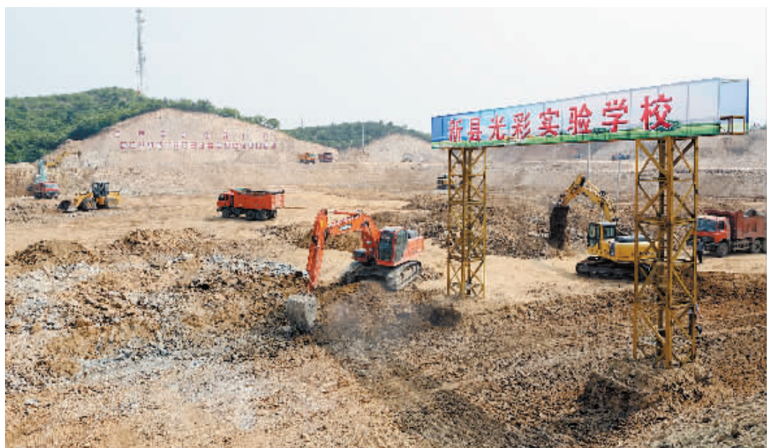
5月23日,新县光彩实验学校正在紧张建设施工。目前,该校正在进行“三通一平”等基础设施建设。该校为寄宿制的九年一贯制学校,建成后解决900名留守儿童寄宿问题。蒋仑摄
