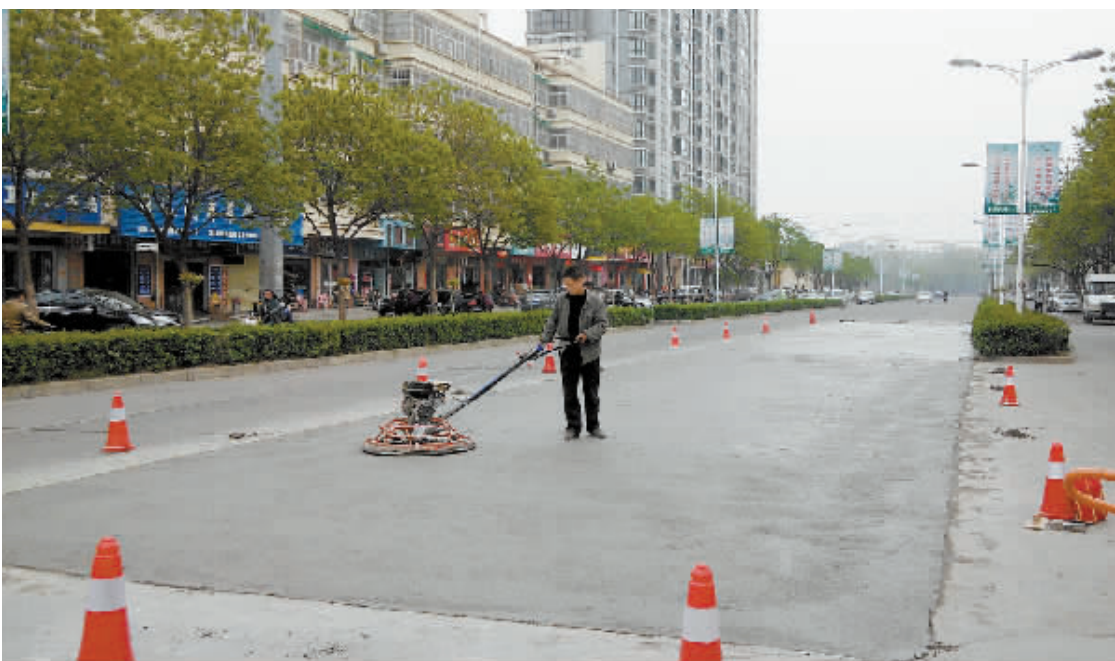
为以良好的城市形象迎接信阳第二十二届国际茶文化节,连日来,我市市政管理部门加班加点,抓紧对中心城区主干道破损路面进行修复。图为昨日上午,市政工人正在抢修行路破损路面。
