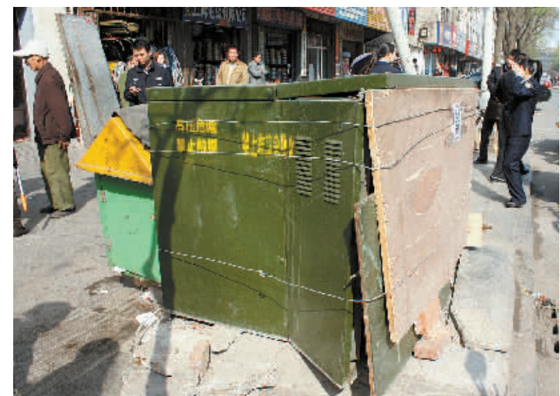
4月5日,记者在浉河区车站办事处采访时,路边一些商户向记者投诉说,在他们店门口有一个高压变电箱破损,但电业部门仅用一块木板和铁丝进行了固定,很是危险。我们希望电业部门能尽快加以解决。图为破损的高压变电箱。
