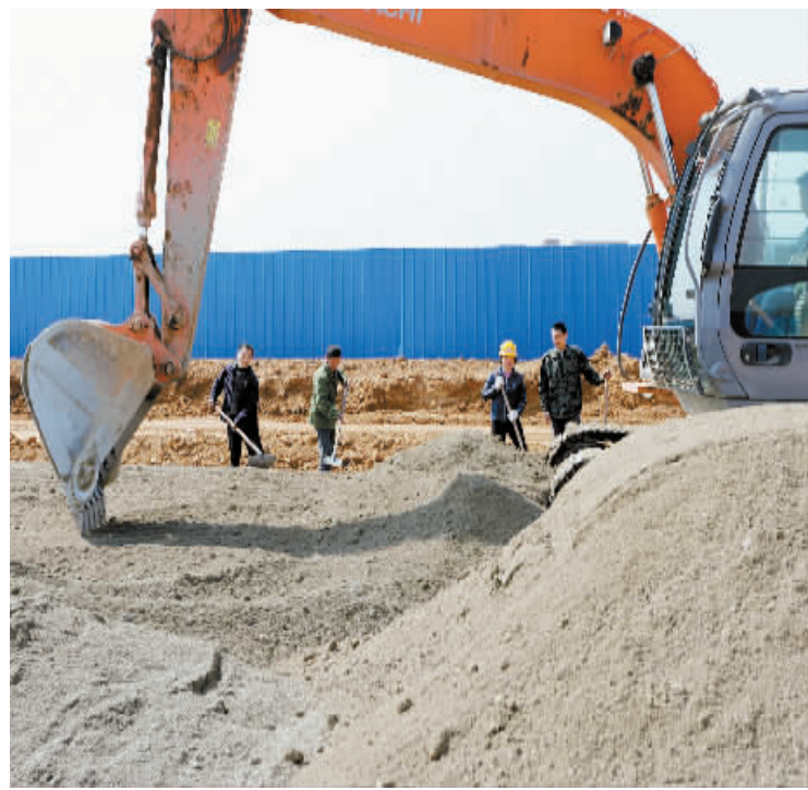
4月2日,信阳国际家居产业小镇城北五建设工地上,建设人员正在认真施工。目前,信阳国际家居产业小镇各主要道路施工进度顺利,各施工单位抓住有利天气条件,增加施工量,加快建设进度。
