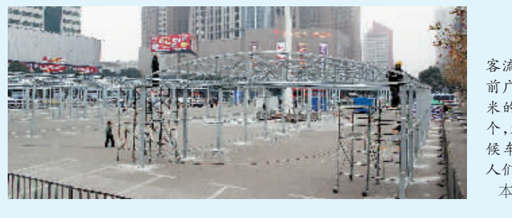
为迎接即将到来的春运客流高峰,信阳火车站在前广场搭建总面积1080平方米的钢架结构临时候车棚4个,为旅客营造安全、舒适的候车环境。图为1月16日,工人们正在搭建临时候车棚。 本报记者 卢小龙 摄
