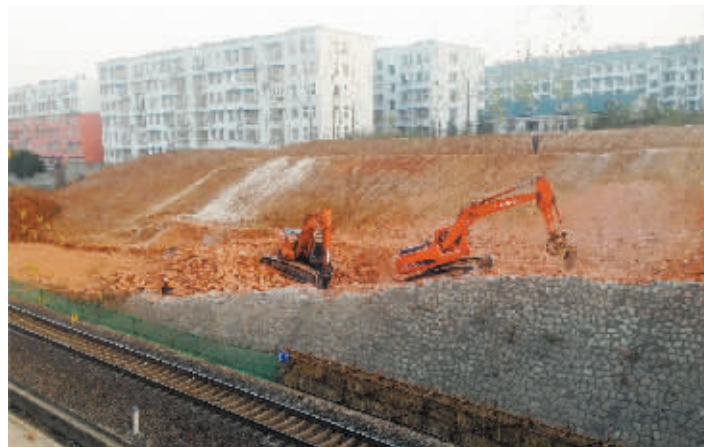
宁西铁路增建二线信阳段工程全长200多公里。项目实施后,速度目标值将由目前80-120公里/小时提高到160公里/小时以上,货物年输送能力由2200万吨提升至5000万吨。目前,宁西铁路增建二线信阳段工程正在顺利推进。图为位于平桥区境内的项目施工现场。本报记者 杨柳 摄
