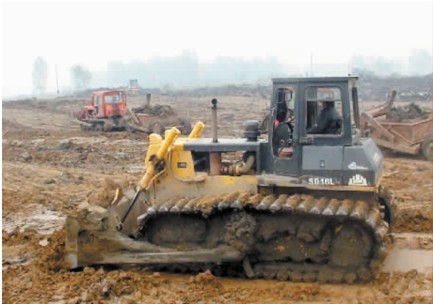
固始县徐家乡村对近期旱情暴露出的水利薄弱环节,早部署、早规划、早行动,要求各村至早完成两口以上万方大塘开挖。全乡18个村居行动迅速,掀起了以大塘开挖、渠系整修为主要内容的冬季农田水利建设高潮。图为该乡白羊村组织机械开挖大塘时的情景。 丁昌明 摄
