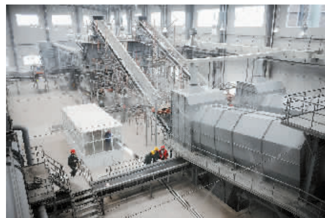
近日,河南省新密市生活垃圾无害化处理项目的现代化垃圾处理设备正式投入运营。该项目总投资1.57亿元,采用国内领先的技术工艺,可日处理垃圾1500吨,年产保温墙砖3000万块。生活垃圾无害化综合处理,还可使垃圾“变废为宝”。新华社记者 李博 摄
