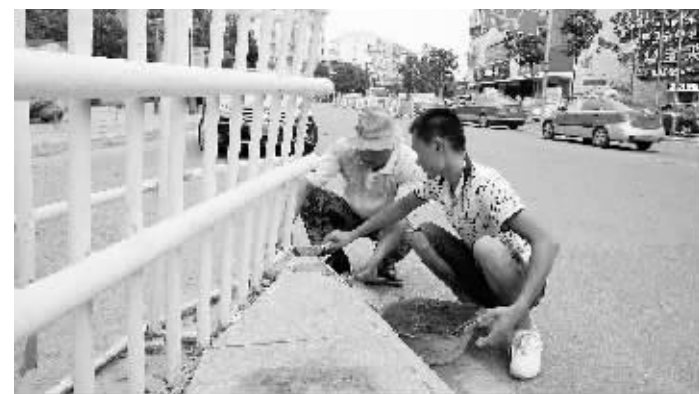
再创全省文明城市测评验收在即,市政管理部门日夜施工,加紧对市中心城区道路、桥梁局部破损部位进行维修。图为8月22日,市政工人在修补中桥北桥头处脱落的瓷砖。 本报记者 方慧玲 摄
