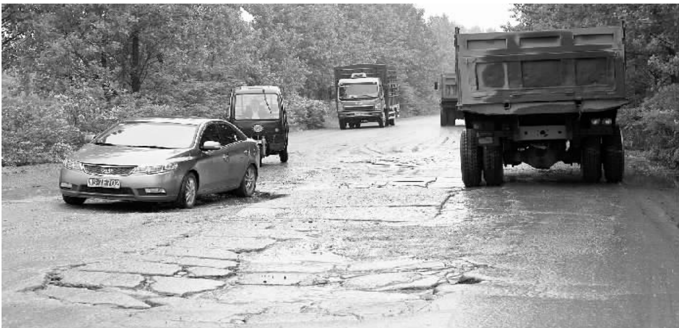
纵贯罗山县南北的罗武公路由于超重卡车碾压和缺乏有效养护,一段段柏油路面上凹凸不平,有的地方甚至布满了大小不一的坑洞,有的直径超过了1米,里面面积满了泥水,过往司机无不叫苦不迭。
