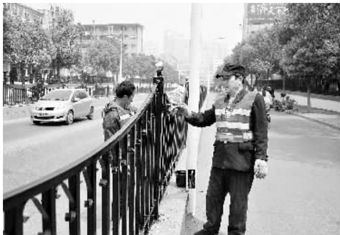
为迎接信阳第21届国际茶文化节暨2013年中国(信阳)国际茶业博览会,扮靓信阳,美化城市环境,昨日,市市政管理处组织工人对火车站立交桥桥下护栏进行清洗刷漆。图为工人工作时的场景。
