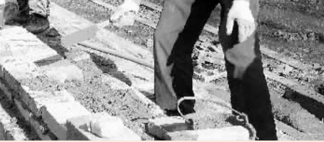
日前,浉河区五星办事处与禾牧源公司联合投资对观音山莲藕基地藕塘景观进行改造,建设集休闲、观光、廉政、教育于一体的“清廉苑”,打造廉政文化品牌。图为工作人员正在施工时的情景。 刘文强 胡燕 摄
