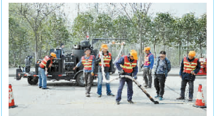
2013年第五届“信阳毛尖·龙潭杯”全国自行车公开赛开赛在即,为营造良好的赛事环境,连日来,城市管理局综合执法局市政二公司精心组织施工力量,加班加点对浙河南路破损路面进行维修。因为工人们正在进行沥青灌缝作业。
