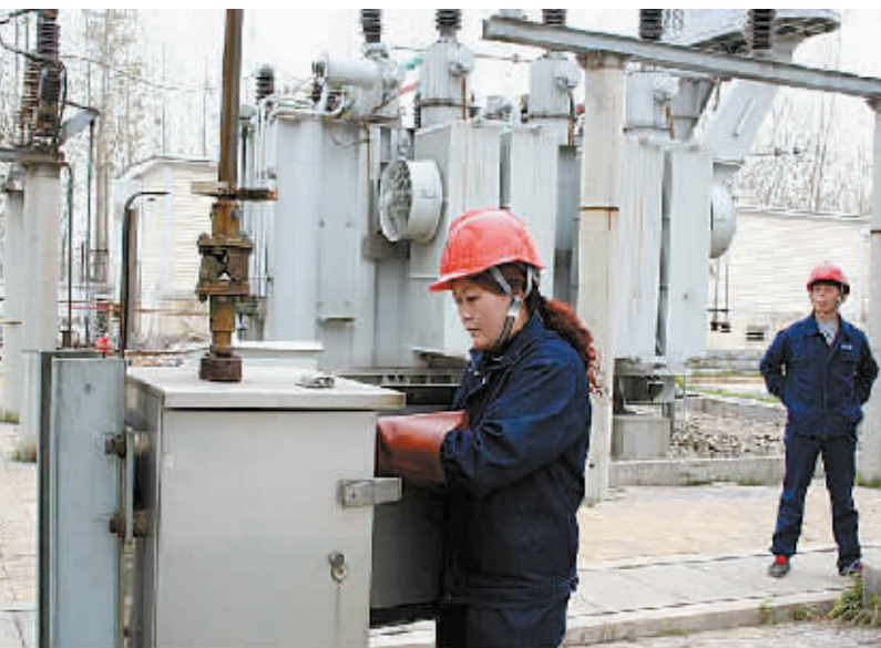
近日,光山县电业局组织技术人员对110千伏紫水变电站电压互感器、避雷器进行预防性试验,及时消除设备隐患,确保电网防雷安全以及群众春耕抗旱期间的可靠供电。图为该局人员正在做电压互感器预试工作。 张磊 摄
