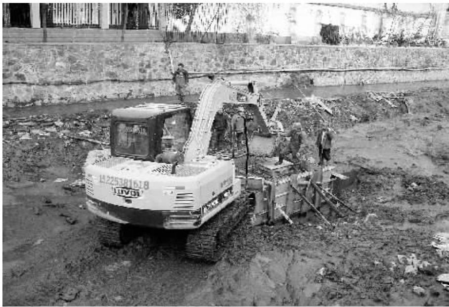
今春以来,我市继续对中心城区内河之一的黑泥沟进行综合治理,治理内容包括清除河道表层垃圾和淤泥、硬化河床、铺设污水管道等工作。图为施工现场。
