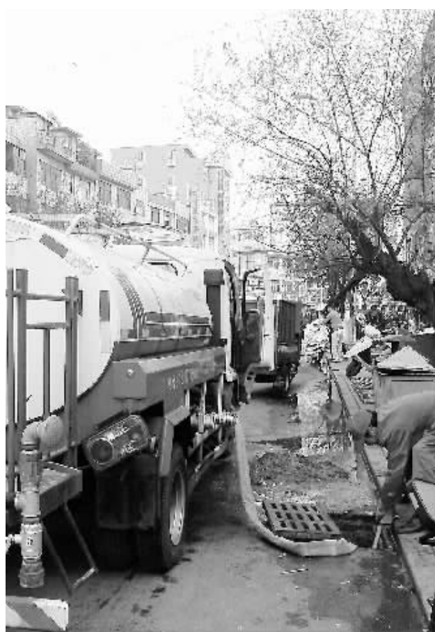
近日,浉河区市政管理局组织人员集中普查、维护中心城区路面市政设施,及时对破损的窨井盖、堵塞的雨水井等进行更换、疏通,切实消除安全隐患。图为中心城区2处下水道疏通现场。
