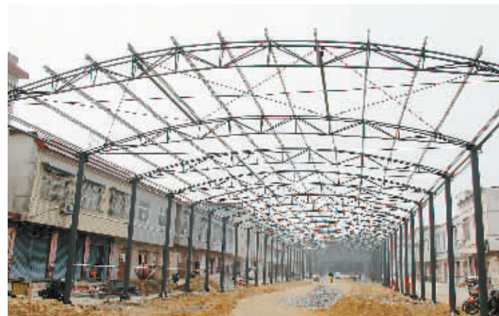
今年以来,平桥区把高标准建设农贸市场作为实施“菜篮子”工程的一项重要内容,加快施工进度,确保工程质量,力争把农贸市场建成为民办实事的一项民心工程。图为平桥办事处正在建设的龙江路农贸市场。 陈星 摄
