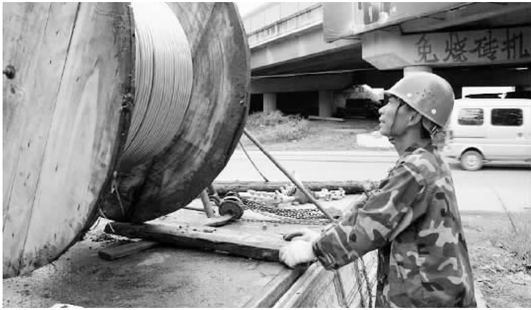
总投资1.6亿元的官渡河供水工程是光山县“一号”民生工程建设项目。8月27日,光山县电业局组织员工冒着高温,为供水主体工程之一的波水水库取水泵站架设专用10千伏线路,工程预计9月中旬竣工。图为供电员工展放导线现场。
