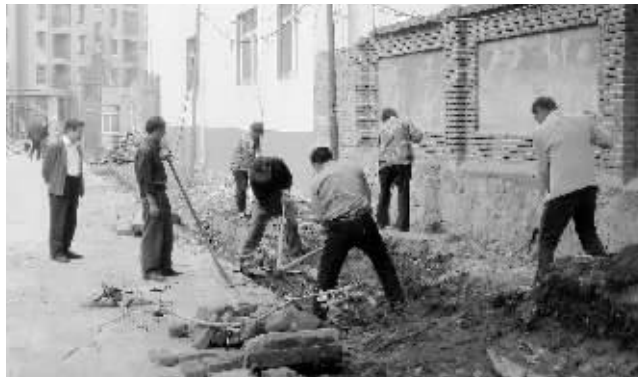
日前,湖东办事处投资6万元,组织专业施工队整治工区路旁的小区道路。图为整治现场。沈勇 摄
