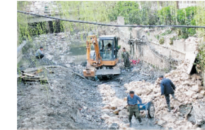
我市中心城区几条内河虽多次治理,但目前淤泥多、气味臭。为净化城市环境,提升市民生活质量,今年,我市投入巨资对这些内河再次治理。图为3月26日上午,施工人员在中心城区内河施工时的情景。本报记者 姚广义 摄
