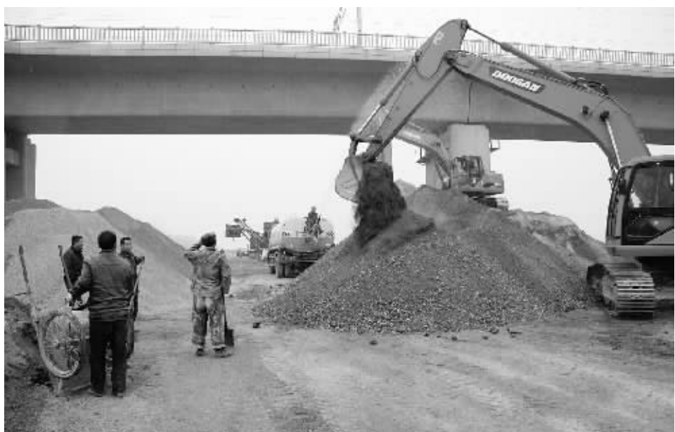
浙河三期治理工程建设项目,对提升全市人民的幸福指数意义重大。图为浙河三期治理平桥段如火如荼的施工场景。
