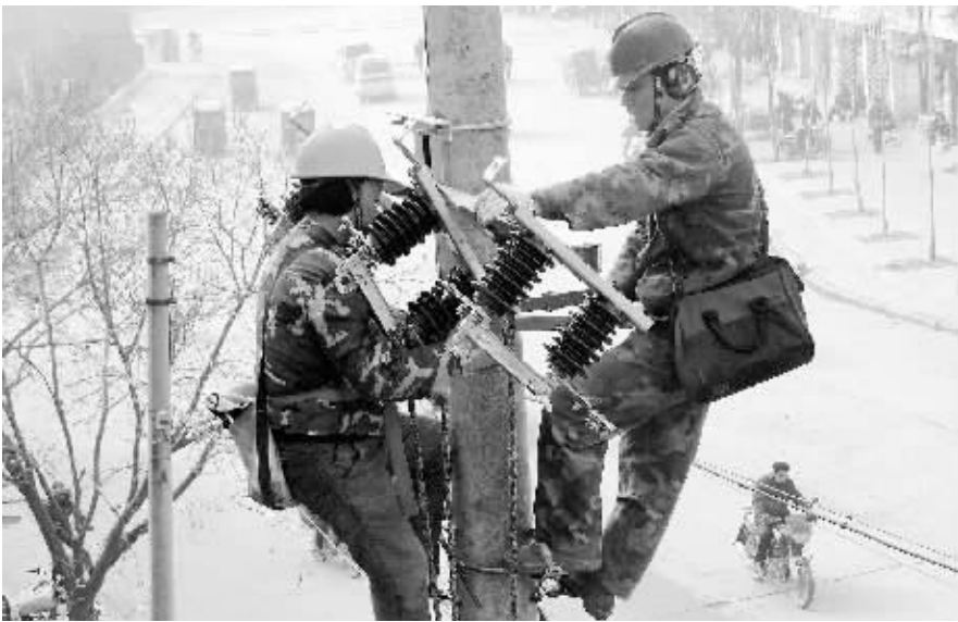
为了确保供电设备稳定运行和安全度冬,日前,息县电业总公司开展了对全县所有变电站设备定检和防腐处理等工作,消除了各类安全隐患。图为该公司员工工作时的场景。 陈平 摄
