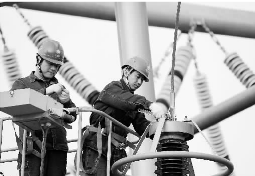
作为信阳电网唯一一座500千伏变电站,浙河变电站在信阳电网的位置举足轻重。日前,信阳供电公司对该站提前进行安检,确保电网安全稳定运行。
