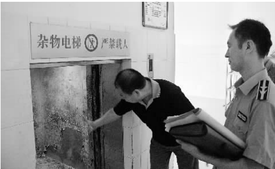
为确保学校在用特种设备的安全运行,保障师生的安全,在新学期开学之前,浉河区质监局组织开展了“特种设备安全进校园”活动,对浉河区辖区内大中专院校和中小学在用的蒸汽锅炉、压力容器和电梯进行了安全检查。图为浉河区质监局工作人员在学校检查在用电梯使用情况。本报记者 曹新俊 摄
