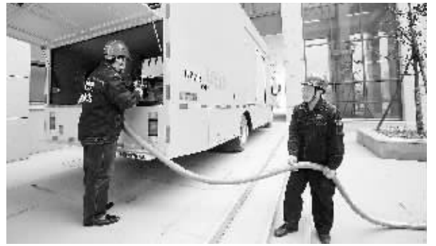
2月25日,信阳市“两会”隆重召开,信阳供电公司全力做好“两会”保电工作。图为该公司工作人员调试应急发电设备,确保可靠供电。
