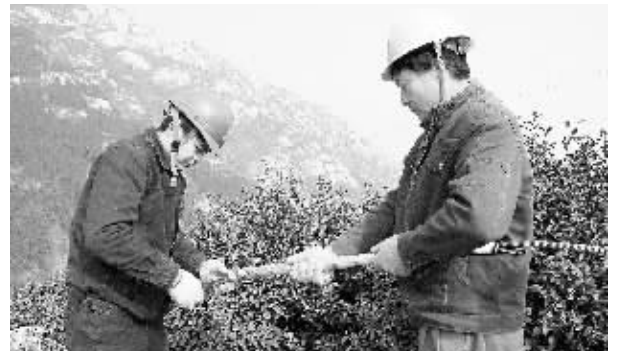
新县电业局结合农网升级改造工程施工规划,大力整治农村薄弱电网,努力服务新农村建设。图为2月23日,该局职工在花果山袁城线分支施工时的场景。
