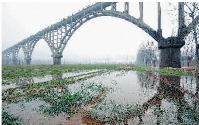
渡槽泄漏的水将下方的麦田变成了“泽国”(2月22日摄)。眼下,河南省各地广大农村正在利用一切抗旱水源浇麦保苗。而记者在嵩县回湖镇铺沟村境内却看到了这样一幅场景:一道道“飞瀑”从一座大型引水渡槽的裂缝处倾泻而下,渡槽下方的大片麦田被积水淹没。大旱之年却遭遇“大涝”,当地村民既痛心,又无奈。据了解,这座大型引水渡槽叫伊河渡槽,全长1323米,最高处41米,是迄今河南省境内最大的引水渡槽。工程1976年开工,几经周折后于1994年竣工。这几年,由于缺乏管理维护,渡槽多个连接处开裂,遇到水库放水经过渡槽时,大量水源从裂缝漏出,白白浪费的同时还殃及下方的麦田。当地村民盼望水利部门早点对渡槽进行彻底维修,管好、用好山区珍贵的水资源。 新华社记者 王颂 摄
