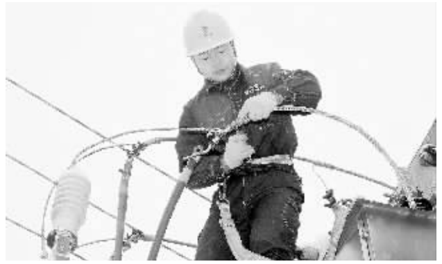
2月12日,淮滨县10千伏淮国线路线夹因超负荷运行烧毁,淮滨县电业局技术人员迅速对故障点进行抢修,很快恢复供电。 陈建侠 摄
