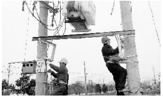
2月11日,光山县境内沪陕高速公路入口至县交警大队路口之间路段路灯安装工程如期开工。图为电力职工冒着严寒正在安装50千伏路灯变压器。 张磊 摄
