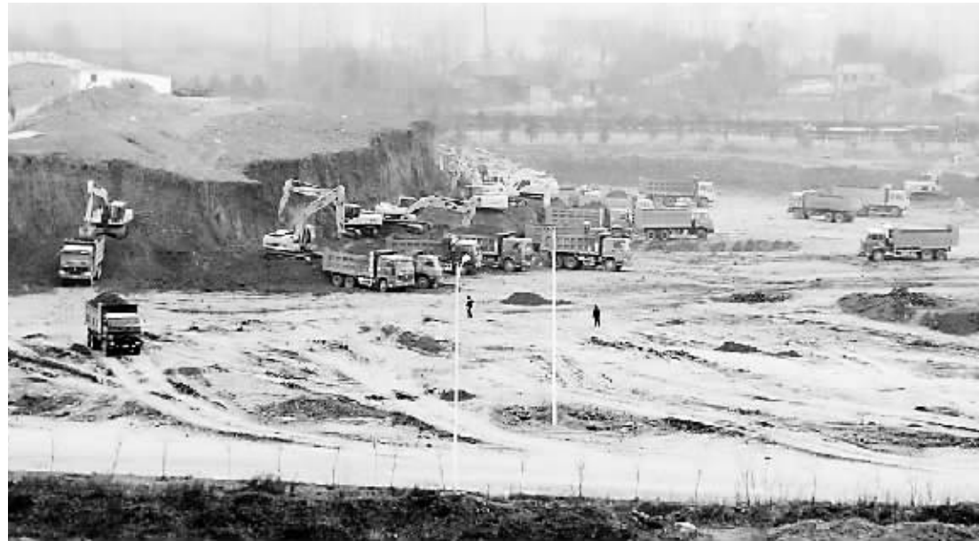
新年伊始,信阳工业城电子产业园一片繁忙景象。经过工程建设者4个多月的奋战,信阳工业城电子产业园场平工作迅速推进,目前已接近扫尾阶段。图为施工现场。彭静 摄
