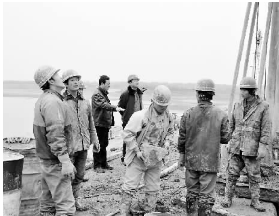
连日来,羊山新区北湖管理区认真贯彻落实羊山新区“决战四季度 大干九十天”会议精神,全力加快重点项目建设步伐。图为北湖管理区主要领导深入辖区重点工程建设现场督导水库大坝施工时的场面。 商立松 摄
