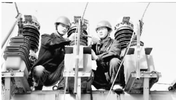
商城供电公司计划用一周时间对变电站主设备进行一次状态检修,为电网迎峰度冬筑牢基础。图为10月19日,该公司变电检修人员正在对110千伏商城变电站设备进行状态检修。 何芊 摄
